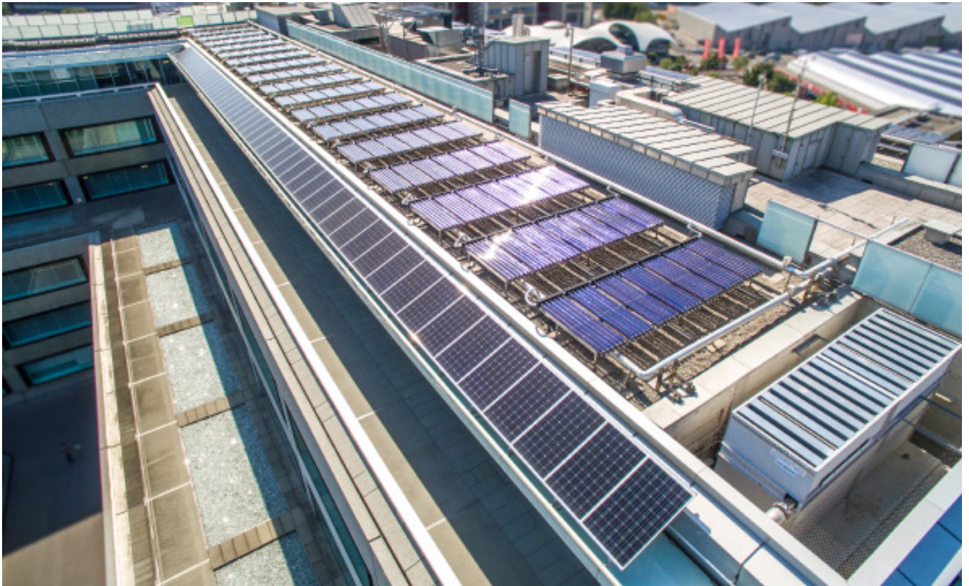
ジュネーブのピクテ本社屋上に設置された太陽熱設備と太陽光発電システム
